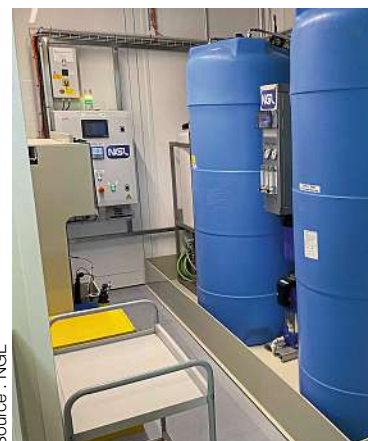
Station de traitement des eaux en amont d'un équipement de nettoyage
